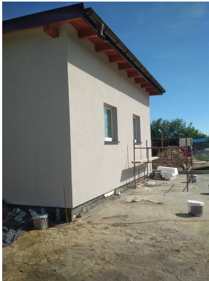
Fot. 6.7. Budynek mieszkalny w Buku Pomorskim w trakcie modernizacji (źródło: ZGKiM w Jabłonowie Pomorskim)
