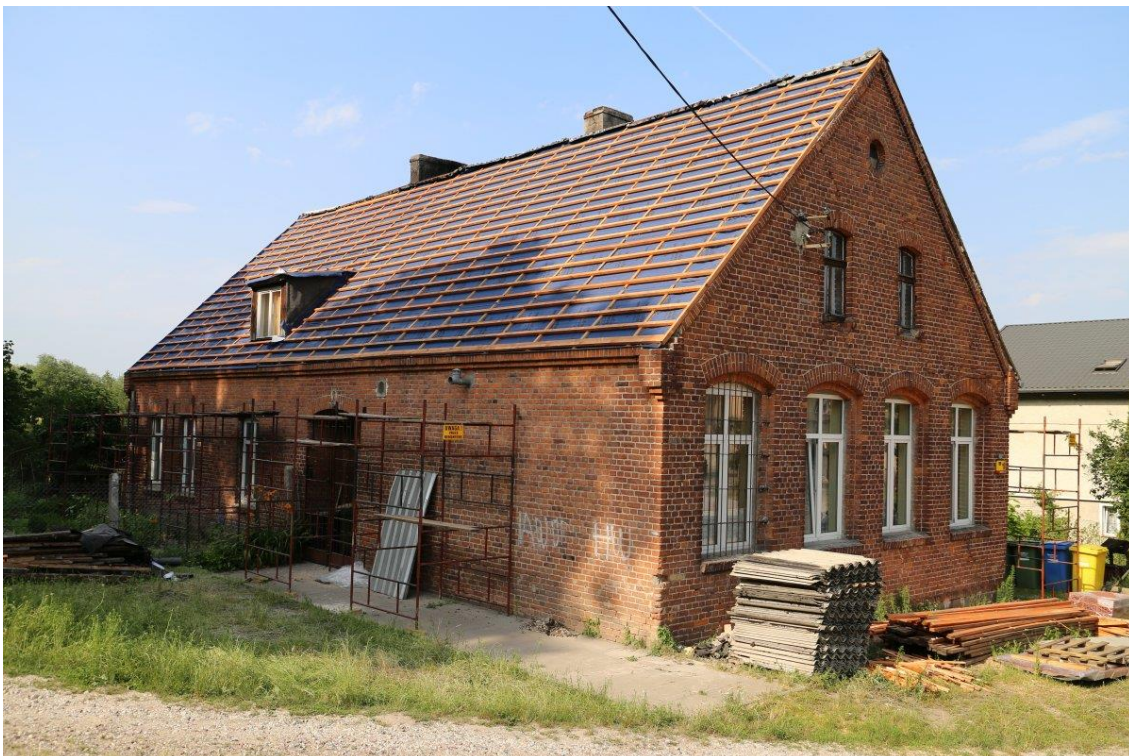
Fot. 6.8. Budynek mieszkalny w Jabłonowo-Zamek 11 w trakcie modernizacji dachu (źródło: ZGKiM w Jabłonowie Pomorskim)
