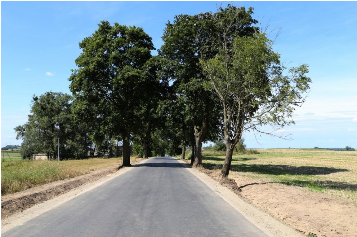
Fot. 4.10. Przebudowa drogi gminnej Buk Pomorski – Świecie nad Osą - etap I" (źródło: UMiG Jabłonowo)
