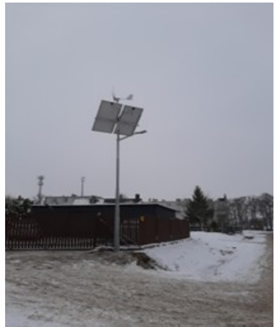
Fot. 4.4. W dniu 29 grudnia 2021 roku na terenie sołectwa Piecewo zamontowano jedną lampę hybrydową (Źródło: UMiG Jabłonowo Pomorskie)
